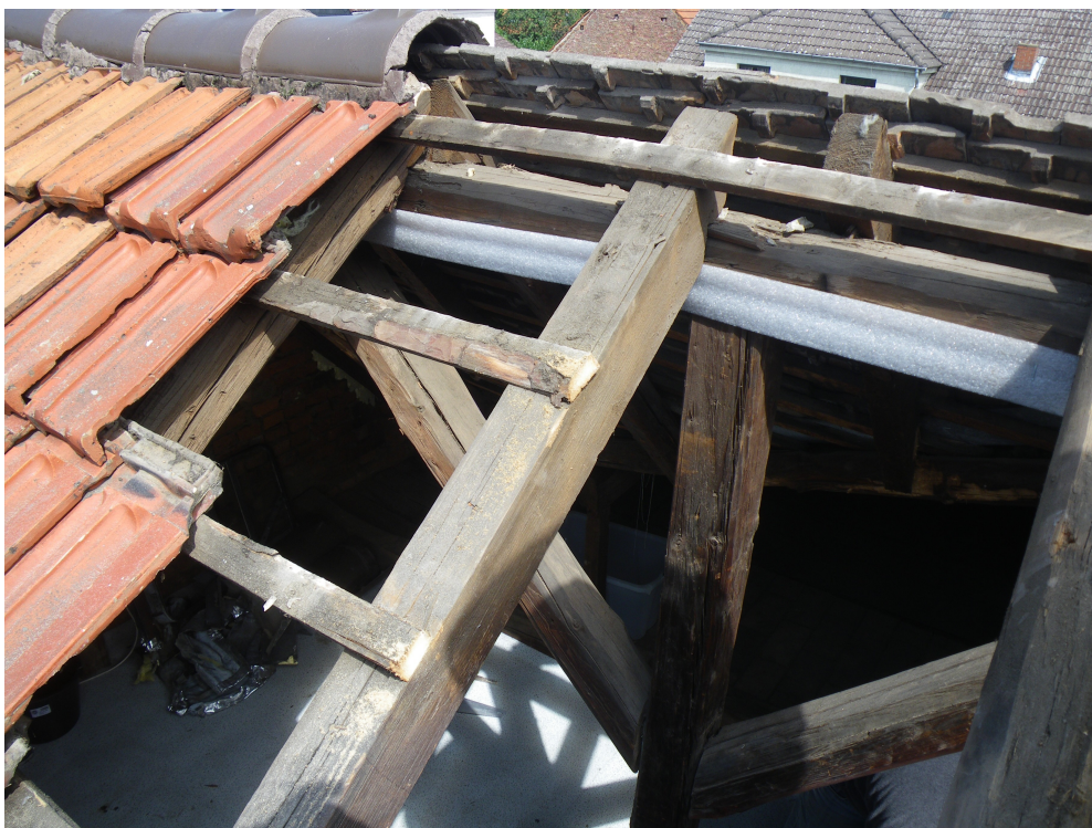
(Abb. 4: Sorgenkind Dach)
